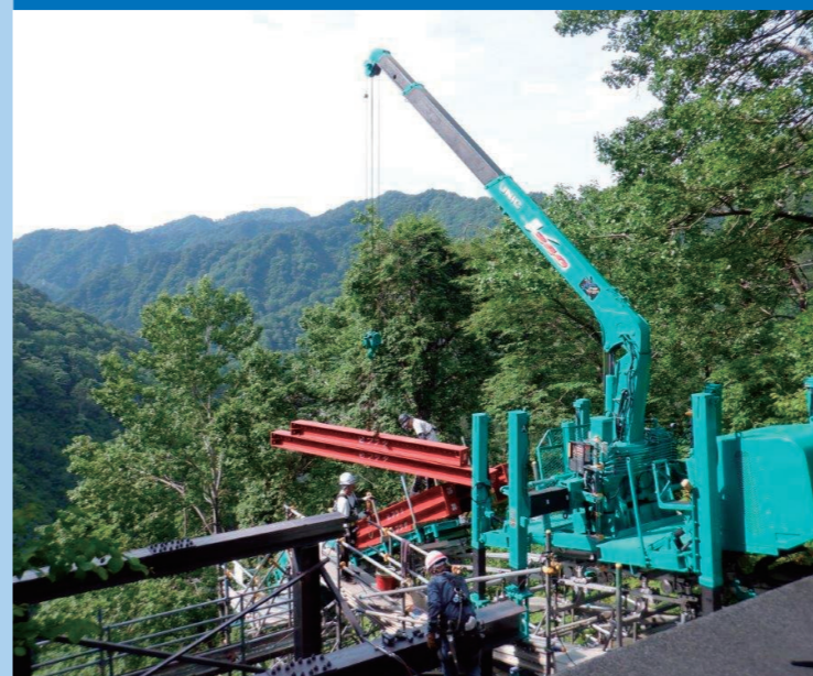
水力発電施設でH鋼などの資材をクレーンで据え付け
