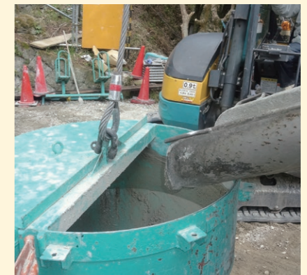
生コンホッパー天面を加工し運搬時の生コンがこぼれるのを防止
